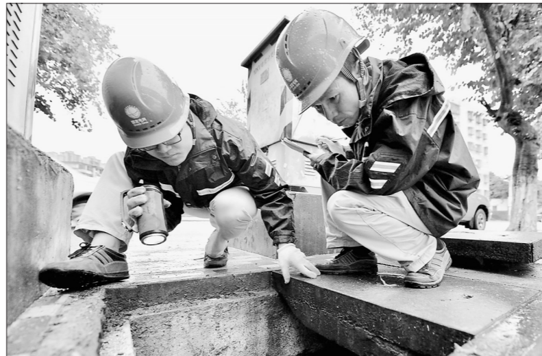
近日,国网南安市供电公司运维人员冒雨对市区低洼地带的环网柜、箱变以及电缆井等进行灾中特巡,确保设备正常可靠运行。 本报记者 林熙 摄
